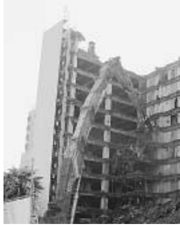
▲アスベストが使われたビルは 今後建て替え時期に入る
